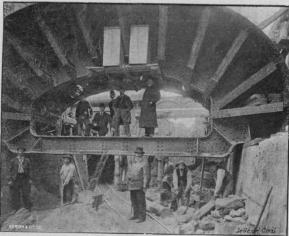
Fig. 37. — Avant du bouclier du 4 e lot se dirigeant vers l'église Saint-Paul ; vue prise le 4 avril 1899.
