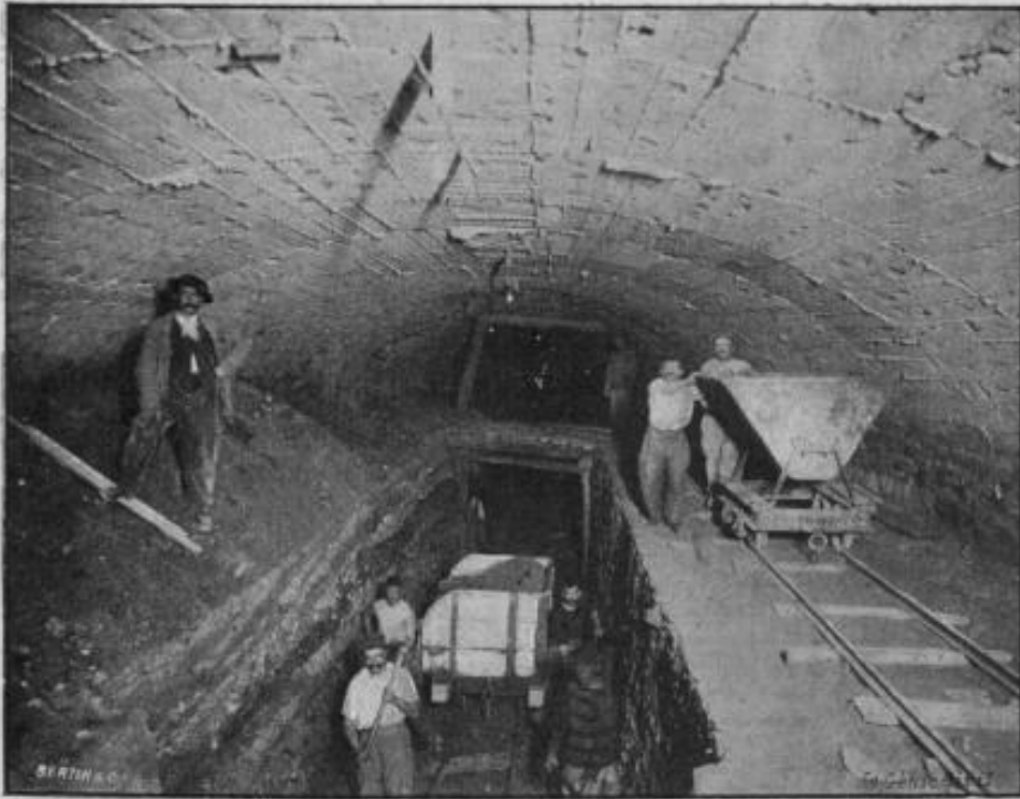
FIG. 18. — Construction du souterrain des Champs-Élysées, au droit de la rue Berri ; vue prise le 13 septembre 1899.
