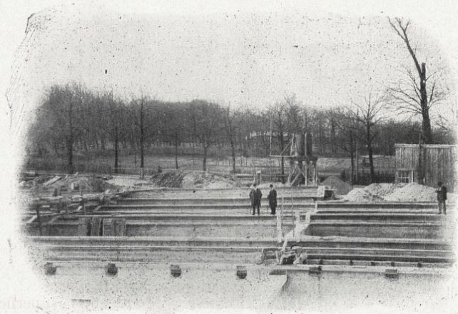
FIG. 30. — Bassins filtrants de la banlieue de Paris.
