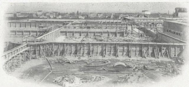
FIG. 28. — Bassins filtrants de la Banlieue de Paris.
