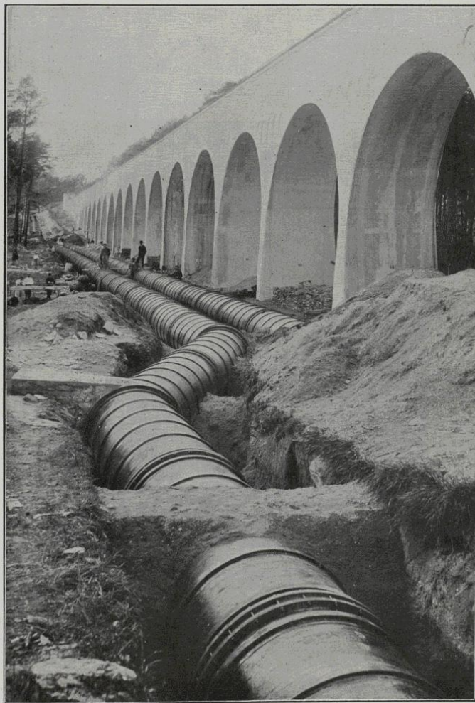
Fig. 13. — Dérivation des sources du Lunain, siphon de la route de Nemours, longueur : 2 800 mètres, diamètre : 1 m. 25.
