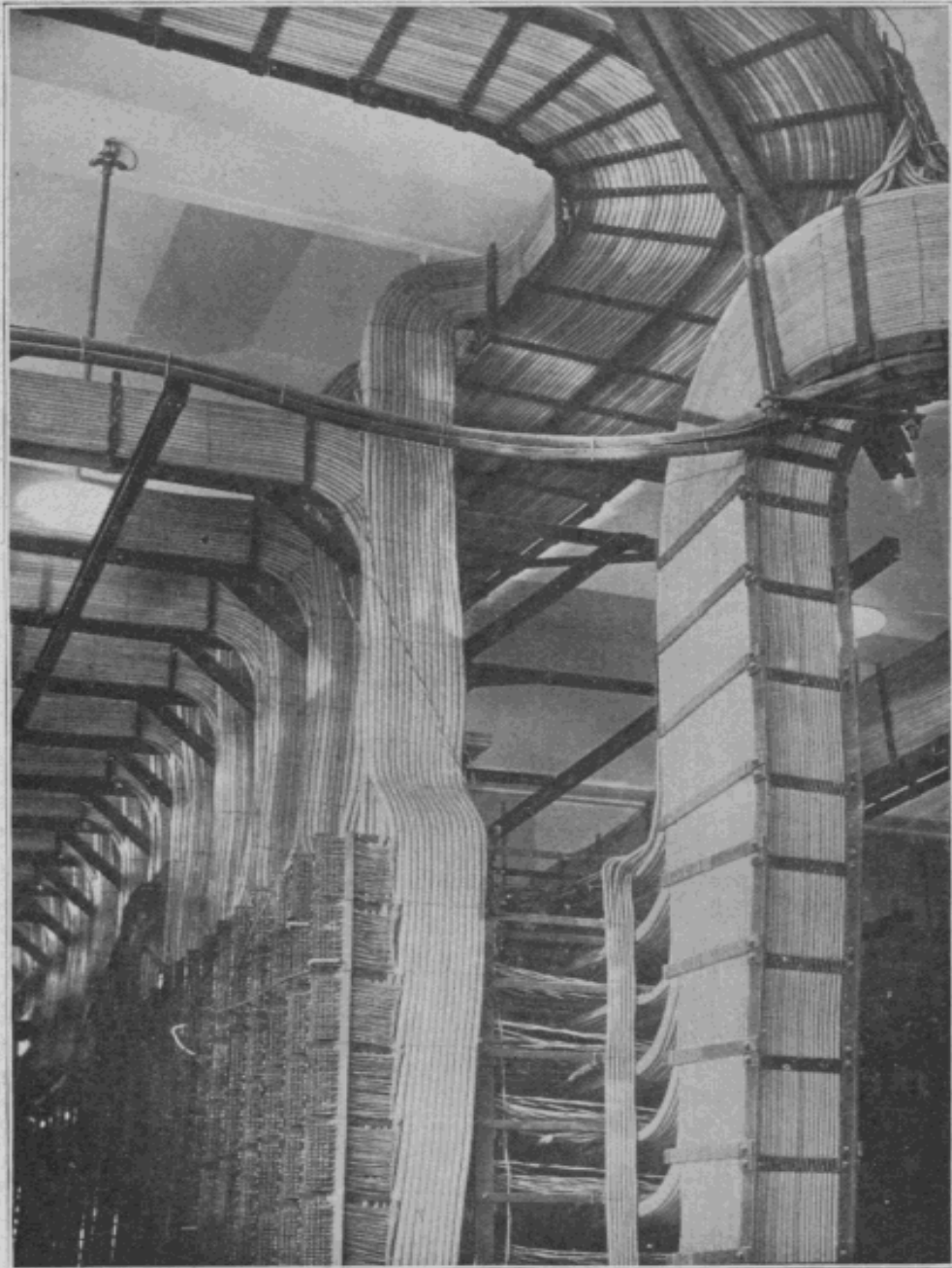
LES RÉPARTITEURS DU CENTRAL TÉLÉPHONIQUE GUTENBERG. Nous voyons ici l'arrivée des lignes téléphoniques souterraines et leur répartition en séries avant d'être dirigées sur les tableaux d'échange de communication. (Cl. Hachette.)
