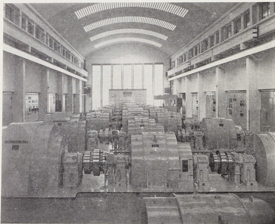
FIG. 24. — La salle des groupes LEONARD associés à des alternateurs à vitesse variable alimentant les bancs d'essais de compresseurs (Centre d'essais de Melun-Villaroche de la SNECMA).
