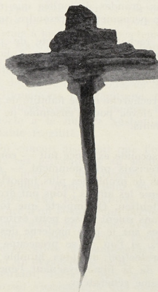
Corrosion d'un boulon \varnothing 8 exposé 7 ans en atmosphère industrielle.
