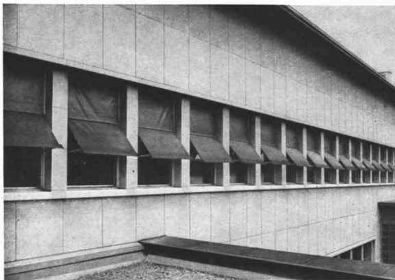
Fig. 29. - Fenêtres de façade du Laboratoire de recherches des Glaceries de la Compagnie de Saint-Gobain. Stores extérieurs en Verre Textile enduit (52, Bd de la Villette, Paris).
