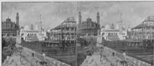
(3) LA BUTTE DU TROCADÉRO VUE DU PONT D'IÉNA, au milieu des travaux d'élargissement de ce pont
