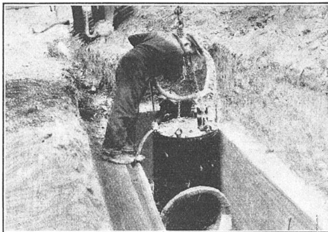
MISE EN PLACE D'UNE BOÎTE CONTENANT LES BOBINES DE CHARGE
