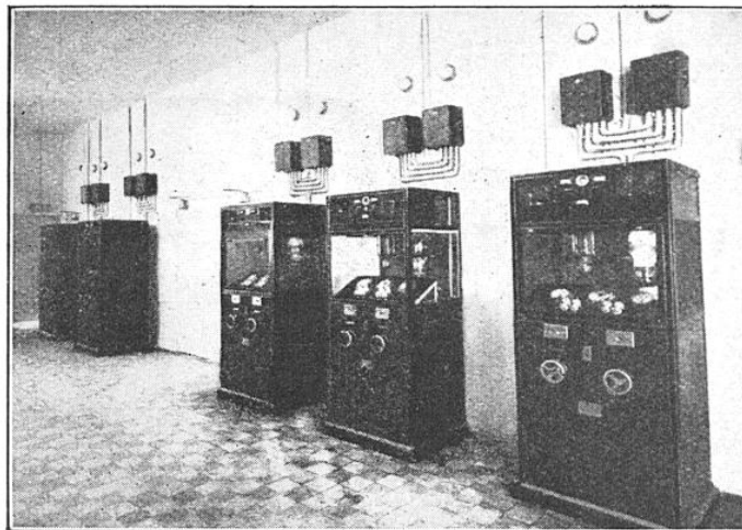
ENSEMBLE DES APPAREILS AMPLIFICATEURS A GRANDE PUISSANCE, FONCTIONNANT SOUS LA TENSION DE 3.000 VOLTS ET POUVANT DONNER CHACUN UNE PUISSANCE DE 200 WATTS SANS AUCUNE DISTORSION
