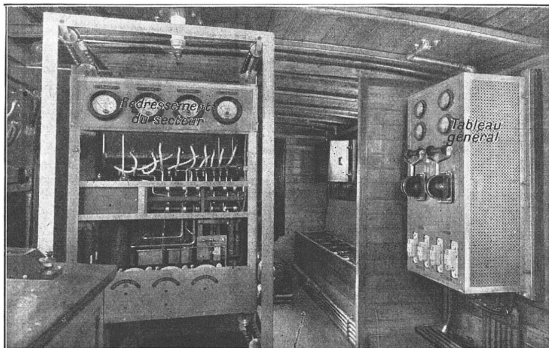
FIG. 4. — CETTE AUTRE VUE INTÉRIEURE MONTRE L'APPAREILLAGE D'ALIMENTATION DU POSTE ÉMETTEUR D'UN CAR AUTOMOBILE DE LA POLICE PARISIENNE
